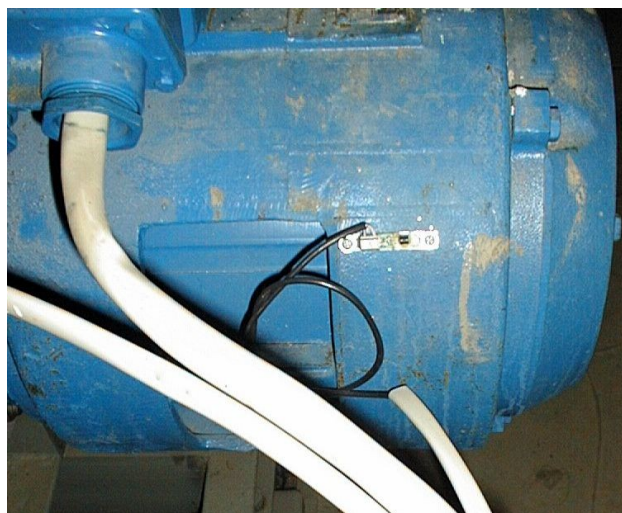
Рисунок 6 - Установка датчика температуры статора электродвигателя
